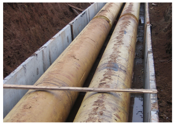
Магистральный теплопровод в ППМИ Ду 530
