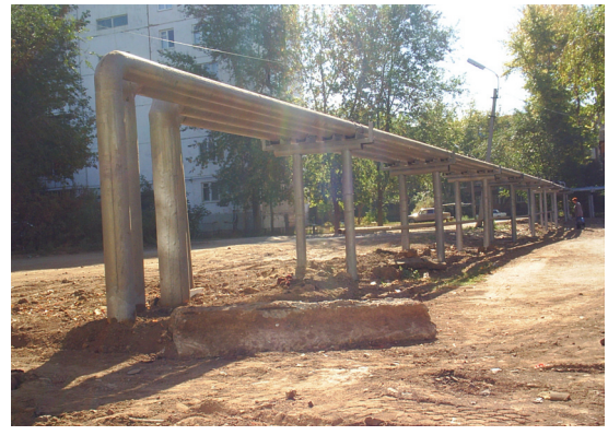
Трубы в ППМИ. Надземная прокладка.
